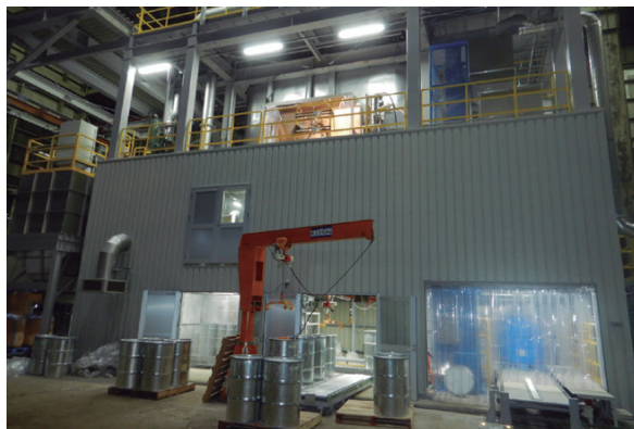
酸化ほう素生産設備 (富山工場 [射水地区])
