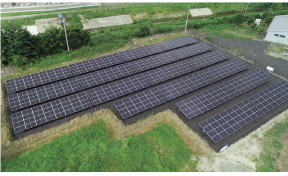
郡山工場の太陽光発電装置
