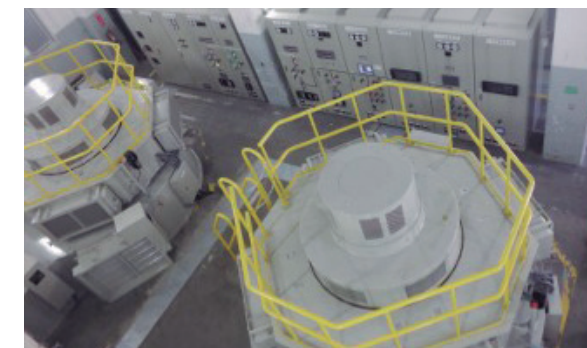
幌満川第2発電所
